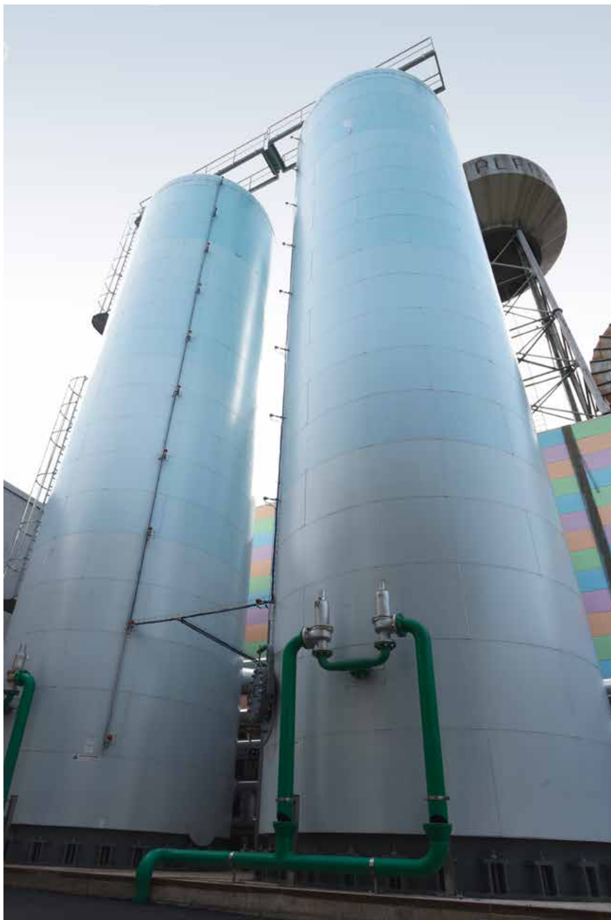
Serbatoi di accumulo acqua calda a servizio dell'impianto di recupero calore
