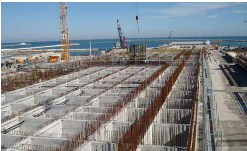
Venezia, bocca di porto di Malamocco. Realizzazione delle strutture che costituiscono la base per le barriere del Mose per la difesa di Venezia dalle acque alte. Attualmente le quattro barriere sono completate
