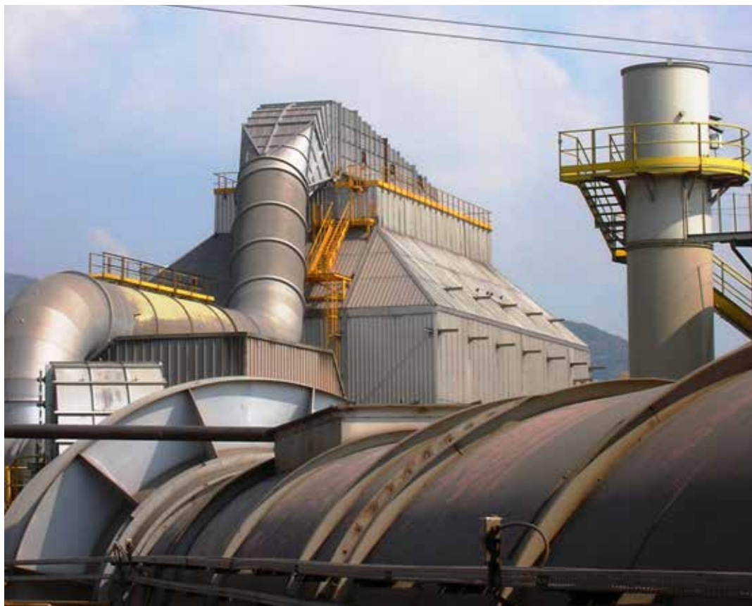
Impianti a presidio delle emissioni in aria
