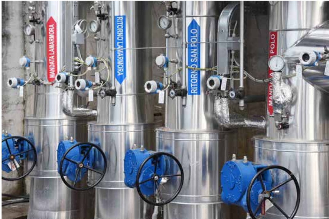
Particolare dell'impianto recupero calore
